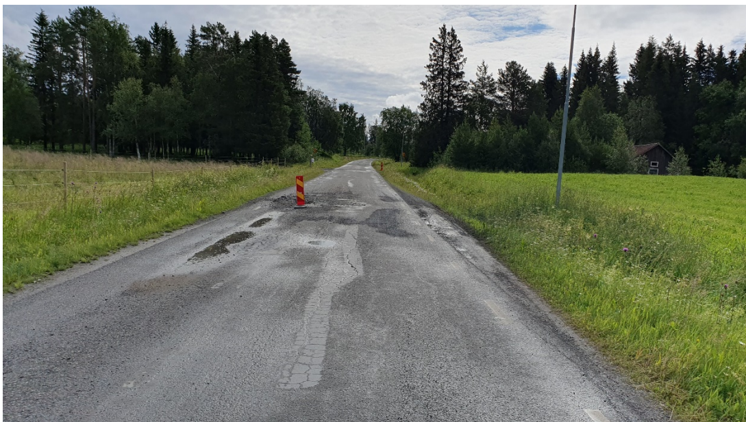
Figur 11 Exempel på väg i det lågtrafikerade nätet som har skador i beläggningen som inte kunnat åtgärdas till följd av begränsade medel för vidmakthållande.
