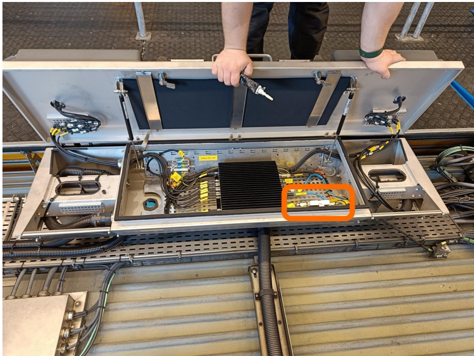
Figur 30 – Starlink ansluts direkt till OxBox som utökas med PoE-injektor för strömmatning av satellitmottagaren
